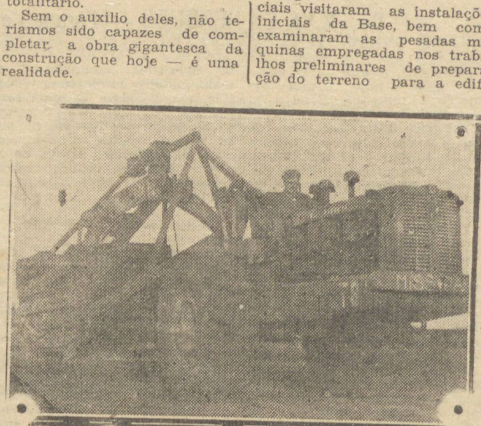
Trabalhadores brasileiros dirigindo moderno maquinário norte americano Os seus esforços são merecedores dos mais altos elogios e eles se tornaram credores da minha sincera admiração. VISITA AS INSTALAÇÕES Depois do café servido no mess hall (refeitório), os oficiais visitaram as instalações iniciais da Base, bem como examinaram as pesadas máquinas empregadas nos trabalhos preliminares de preparação do terreno para a edificação das futuras pistas de aterrissagem. Em conjunto, a maquinaria completa importará em 750 mil dólares. 170 operários brasileiros estão sendo empregados e seu numero aumentará
